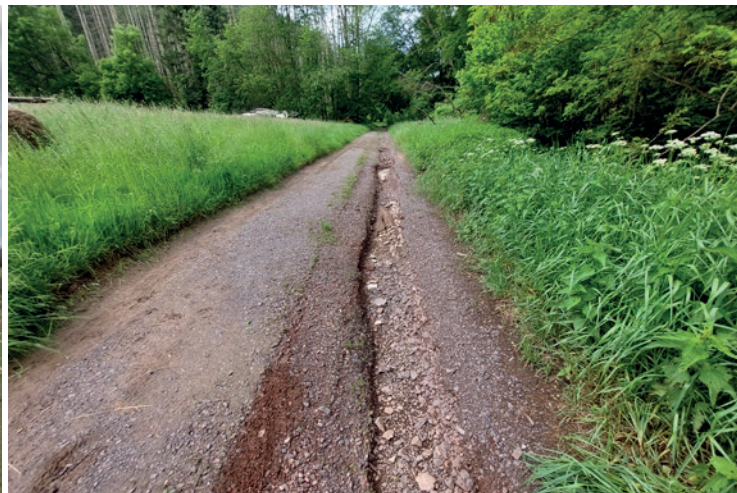
Hochwasserschäden im Peppinger Loch
